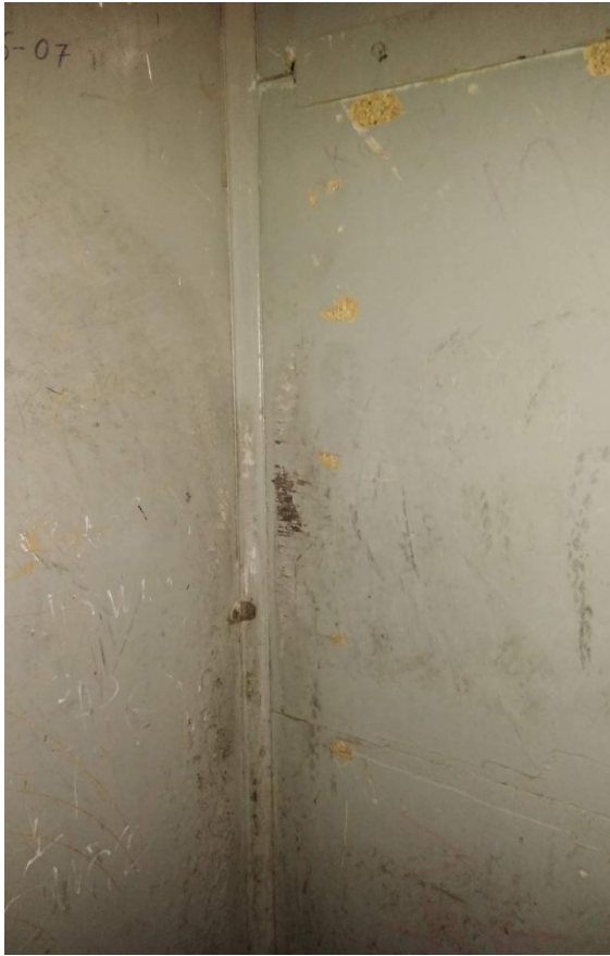
Фото до ремонту
